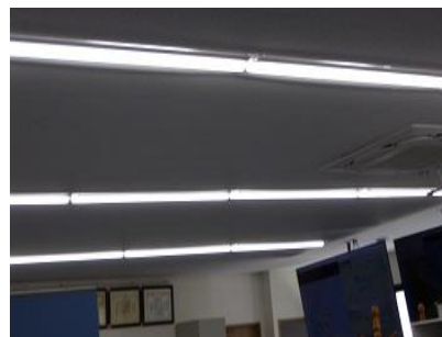
LED 照明・省エネエアコン
