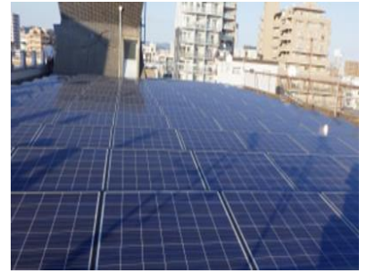
自社ビルの太陽光発電
