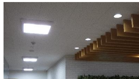
自動センサー付 LED 照明
