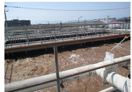
排水処理施設
