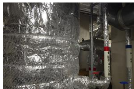
エネルギー室
