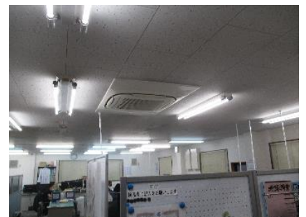
LED 照明、省エネ型エアコン
