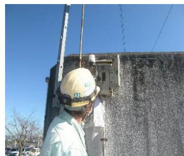
ブレーカーと自動点滅器の確認
