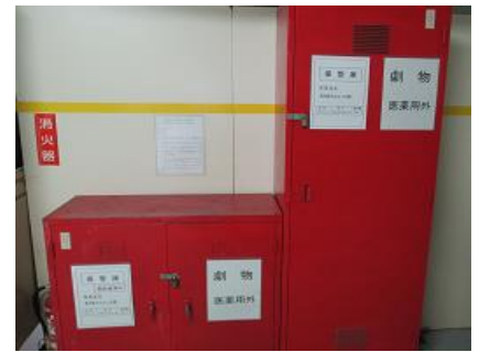
化学物質の保管ロッカー
