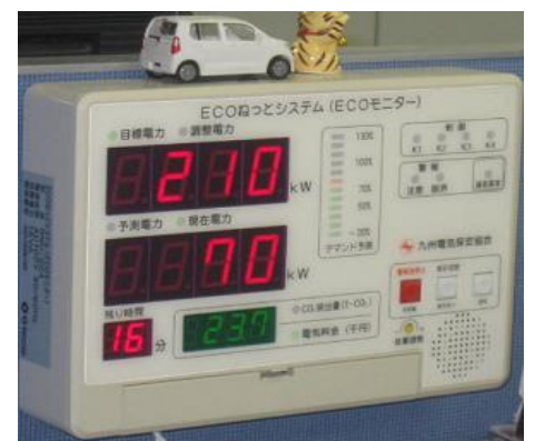
デマンドコントロール
