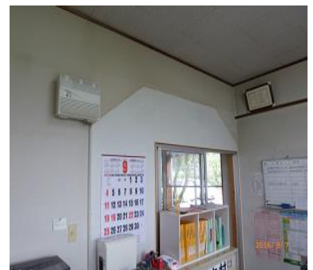
間仕切りによる空調の個別管理
