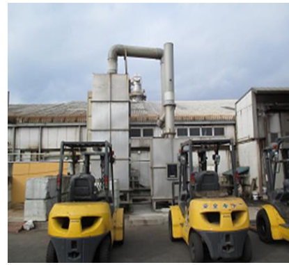
堆肥舎の脱臭対策装置
