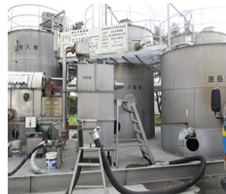
油水分離施設
