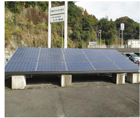
ソーラー発電（3kW）
